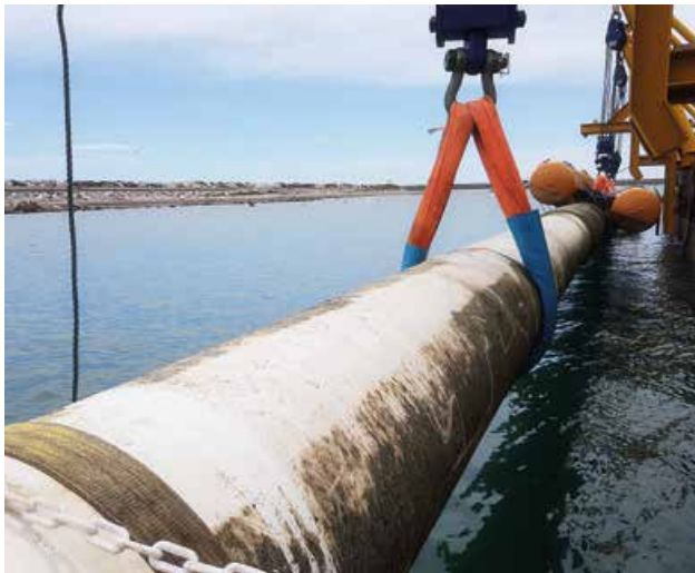
Opération de pose de la canalisation dans la darse du port de Sète (Hérault)
