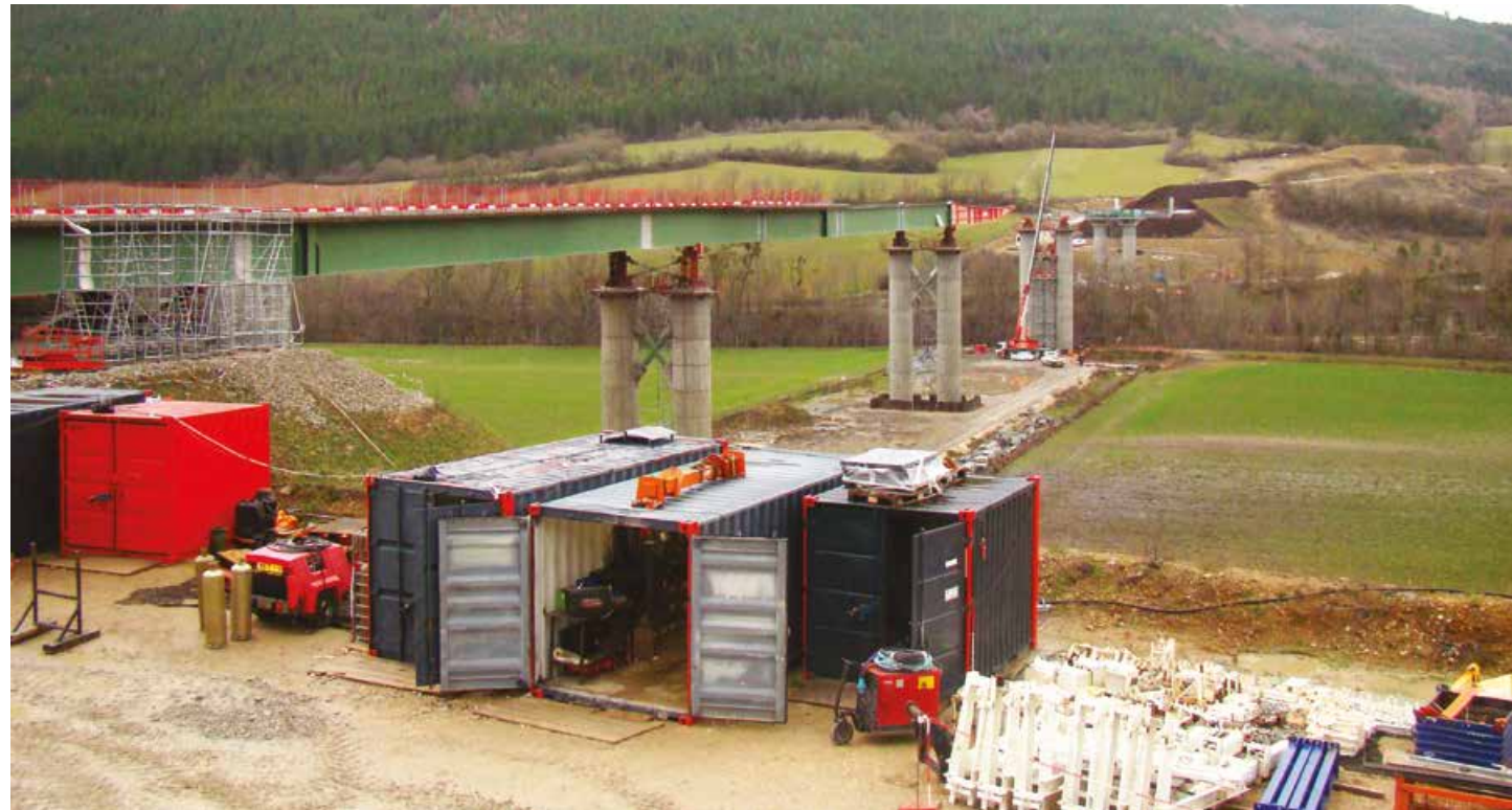
Lancement du tablier du pont sur la rocade ouest de Mende (Lozère)
