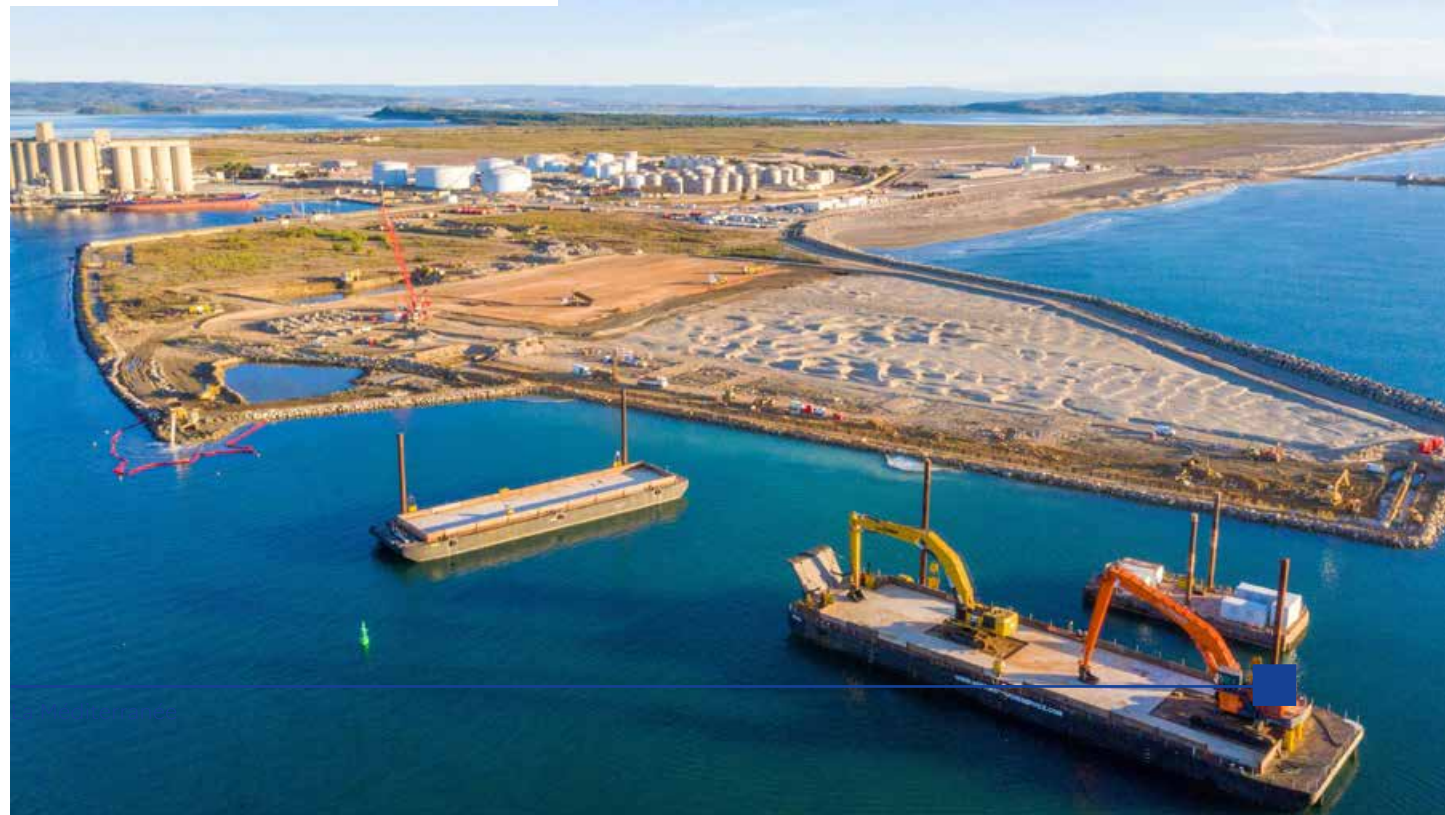
Chantiers en cours de l'extension du port de commerce de Port-la-Nouvelle (Aude)
